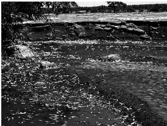
Рис. 3. Плотина-отстойник, к северо-западу от Севильи после разрушения.
